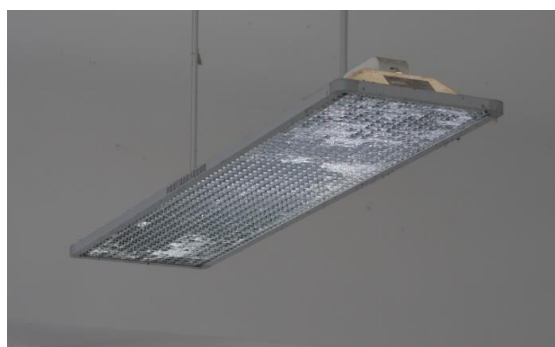
图5 教室灯顶部堆积灰尘、底部有蜘蛛网
